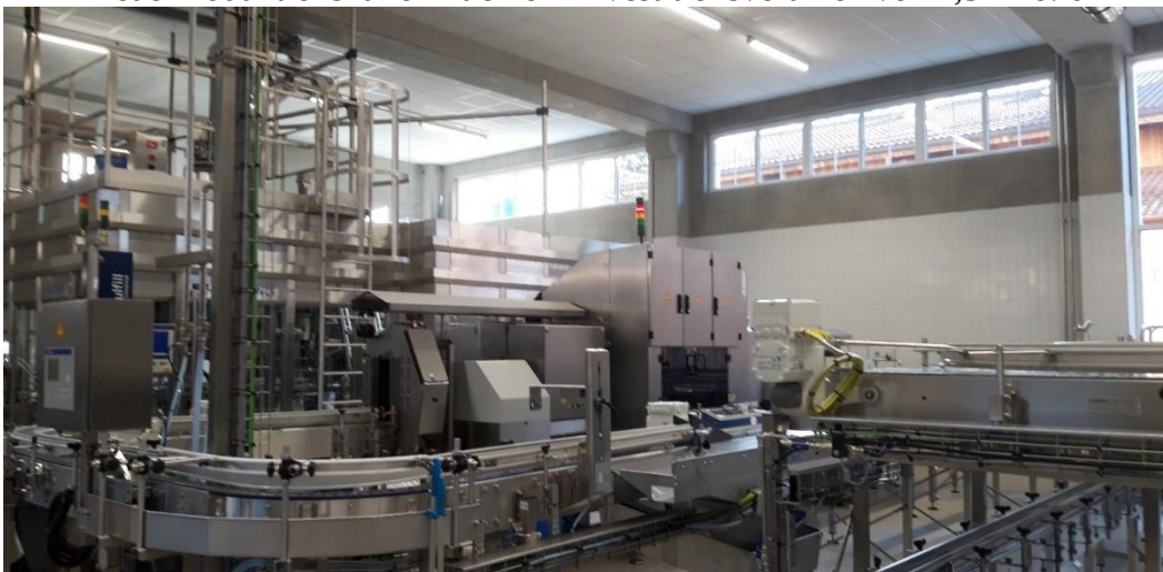
Fast fabrikneue Abfüllanlage inkl. Flaschenreinigungsmaschine in Maxlrain
